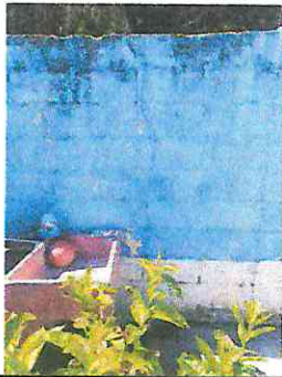
Foto 1: Daño del muro Perimetral
