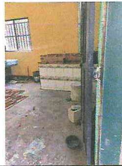
Foto 4: Corte de lado inferior de cuatro puertas de metal
